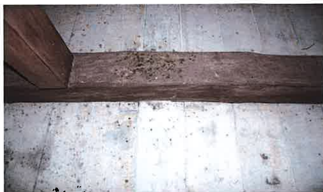
Fot. nr 114 Konstrukcja więźby dachowej-belka stropowa-widoczne ślady żerowania owadów i odchody ptaków
