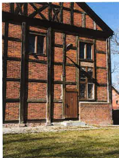
Fot. nr 140 Ściana wschodnia - widoczne wprowadzone dodatkowe okno, zmieniające pierwotny rytm i wielkość otworów okiennych
