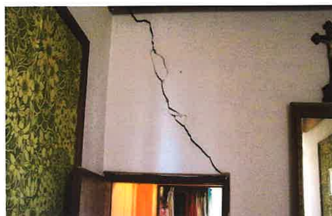
Fot. nr 149 Ściana wewnętrzna (zakrystia) ukośne pęknięcie ściany o dużym rozwarciu
