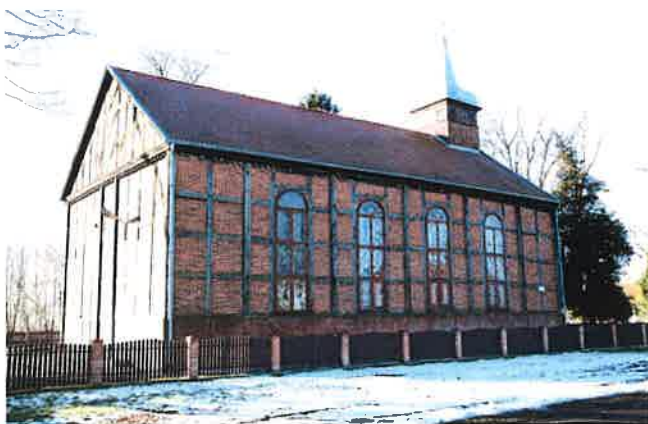
Fot. nr 41 Ściana północna – widoczna wysoka ściana fundamentowa oraz odkształcenie narożnika północno -zachodniego
