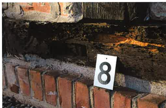
Fot. nr 25 Ściana południowa – uszkodzone i porażone przez korozję biologiczną (m.in. owady i grzyby) elementy podwaliny; widoczne wypełnienie zaprawą wykonane w 2009 roku
