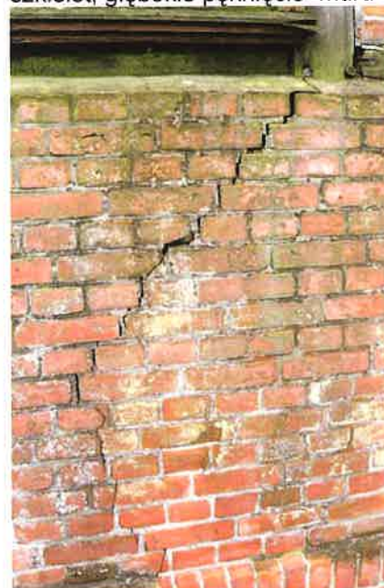
Fot. nr 74 Ściana północna - głębokie pęknięcie ściany fundamentowej
