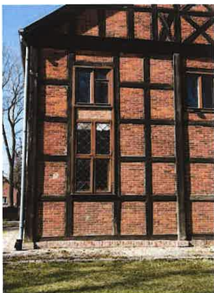
Fot. nr 35 Ściana wschodnia-widoczny wprowadzony nowy otwór okienny zaburzający pierwotną formę stolarki okiennej
