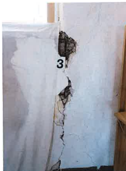
Fot. nr 88 Ściana południowa - stan tynków wewnętrznych; widoczne płyty odpadającego tynku; pęknięcie ściany na „wylot” wzdłuż słupa konstrukcji drewnianej
