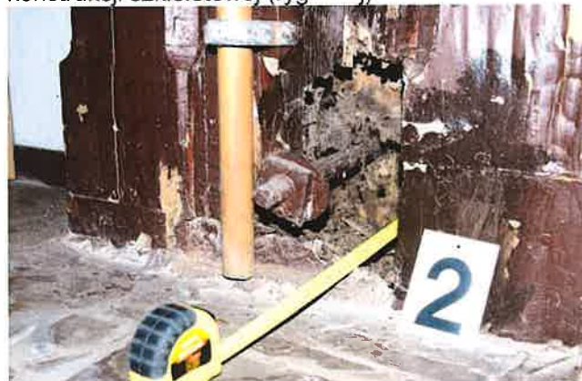
Fot. nr 84 Uszkodzone słupy drewniane w kształcie litery T ściany zewnętrznej – ściana południowa; całkowite zniszczenie struktury drewna w poziomie przyziemia
