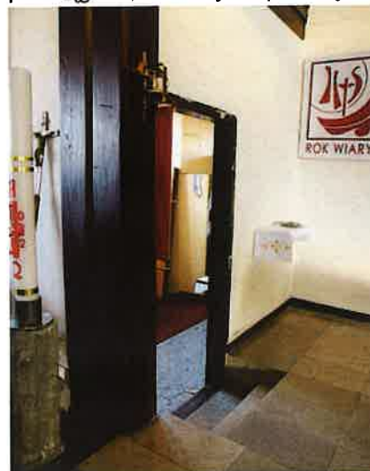
Fot. nr 96 Wejście do zakrystii - widoczna różnica poziomów oraz zawilgocenia ściany wewnętrznej (prostopadłej) do ściany północnej
