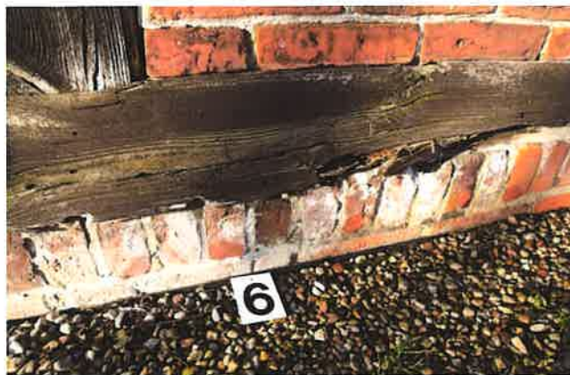
Fot. nr 18 Ściana południowa – uszkodzone i porażone przez korozję biologiczną (grzyby i owady) elementy podwaliny
