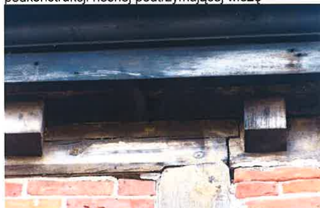
Fot. nr 55 Widoczne ubytki w elementach „ozdobnych” nabitych wokół gzymsu obwodowego na rygle konstrukcji nośnej
