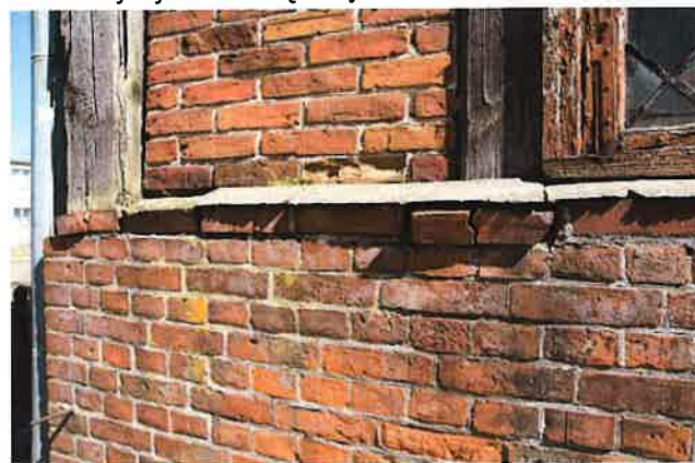
Fot. nr 32 Narożnik południowo – zachodni – zwieńczenie muru cokołowego (fundamentowego); widoczne „luźne” cegły wypełnienia ścian ryglowych oraz stan cementowego okapu (widoczne spękania oraz luźne fragmenty)
