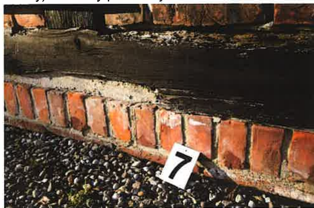
Fot. nr 20 Ściana południowa – uszkodzone i porażone elementy podwaliny; widoczne wypełnienie zaprawą wykonane w 2009 roku
