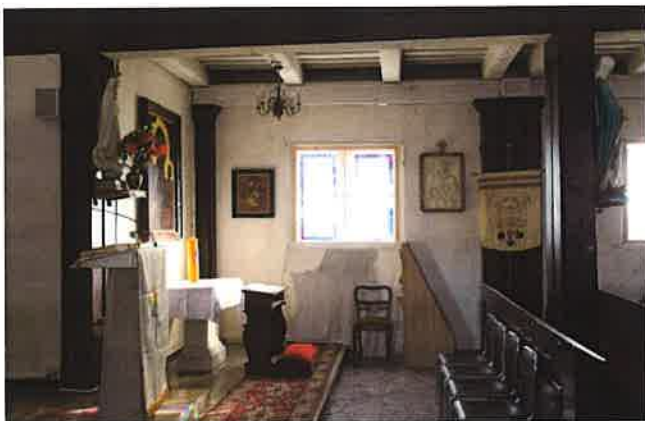
Fot. nr 93 Ściana południowa - stan tynków wewnętrznych; ściana zasłonięta folią PE ze względu na pęknięcie „na przestrzał”
