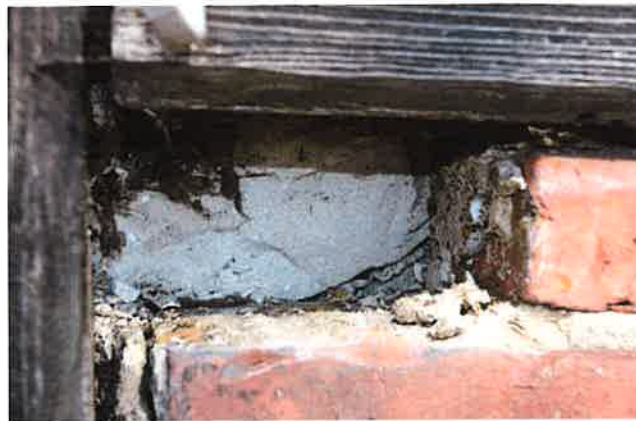
Fot. nr 30 Ściana południowa – widoczne „luźne” cegły muru wypełniającego; otwór na wylot w głębi widoczny tynk wewnętrzny
