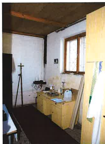
Fot. nr 97 Północno - wschodni narożnik (zakrystia) – widoczne zawilgocenie ściany aż do poziomu parapetu okna (efekt braku izolacji poziomej)
