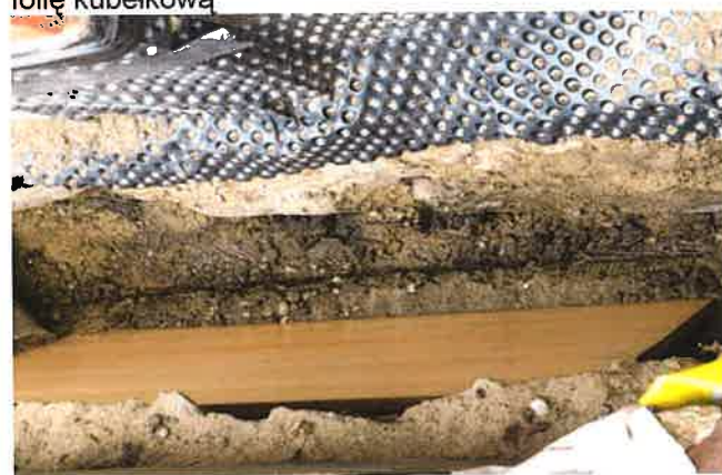
Fot. nr 124 Ściana południowa - odkrywka fundamentów; widoczna folia kubełkowa oraz zawilgocona ściana fundamentowa
