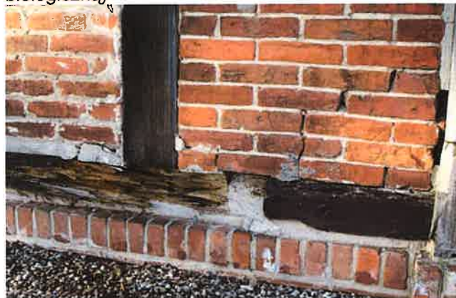
Fot. nr 14 Ściana południowa – porażone przez korozję biologiczną podwaliny oraz widoczne spękania oryginalnego muru; widoczna nieudolna próba wymiany fragmentu uszkodzonej podwaliny podczas prac naprawczych i remontowych w 2009 roku
