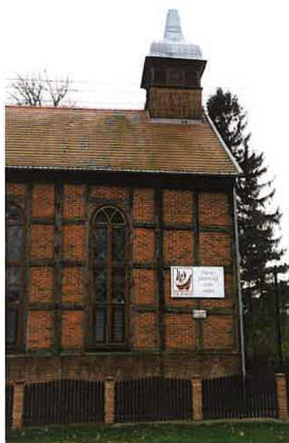
Fot. 50 Ściana północna – widoczne skutki osiadania narożnika
