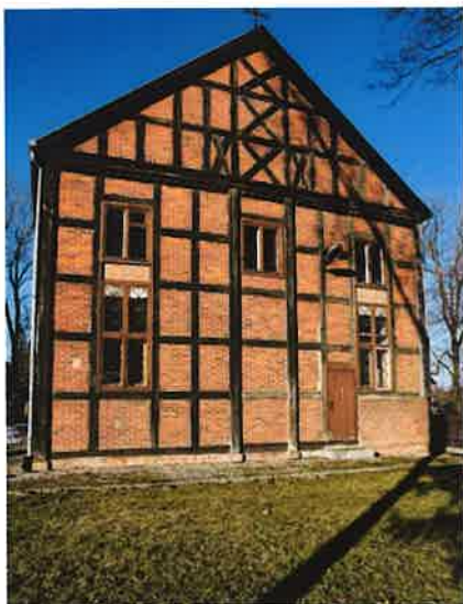
Fot. nr 139 Ściana wschodnia - widoczne wprowadzone dodatkowe okno, zmieniające podział i wielkość pierwotnych otworów okiennych
