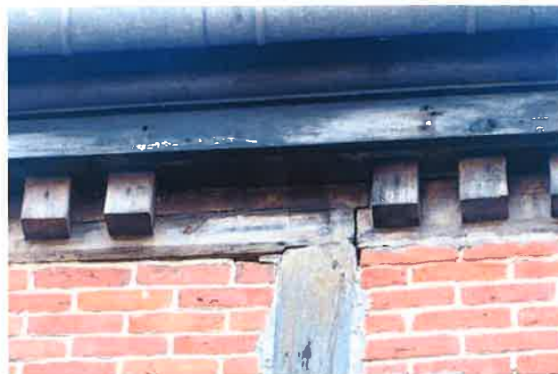
Fot. nr 58 Widok (prawdopodobnie oryginalnego) gzymsu obwodowego- widoczne ubytki w elementach „ozdobnych” – ściana północna
