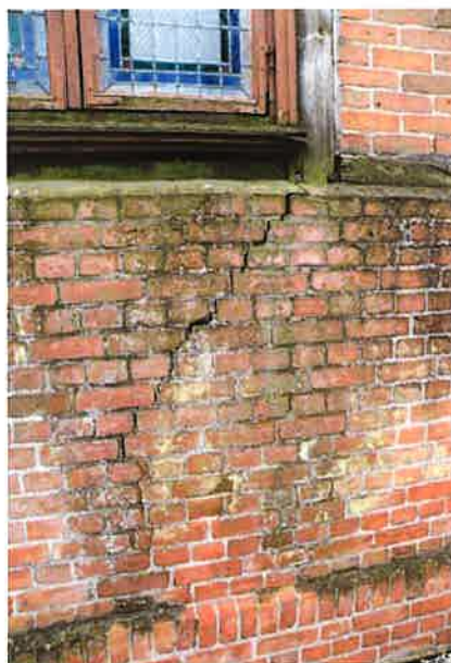
Fot. nr 48 Ściana północna – widoczna wysoka ściana fundamentowa na której występują pęknięcia muru; pęknięcia przechodzą przez całą grubość muru, aż do poziomu fundamentu
