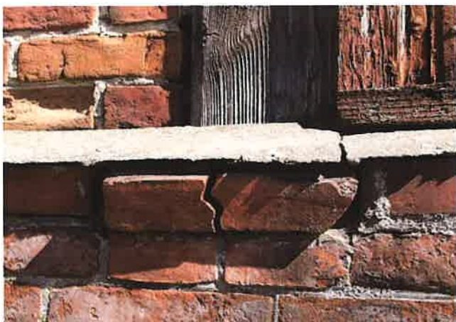
Fot. nr 69 Ściana południowa – uszkodzone cegły pod słupem konstrukcji ryglowej opartym na przemurowanej wysokiej ścianie fundamentowej
