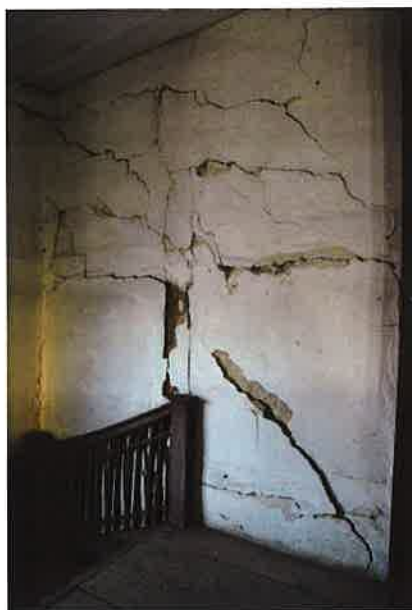
Fot. nr 82 Ściana północna – stan tynków wewnętrznych; widoczny zarysowany kontur konstrukcji szkieletowej (ryglowej)
