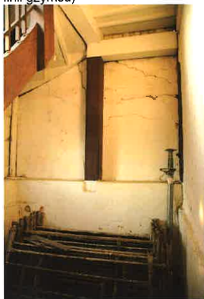
Fot. nr 78 Wewnętrzna drewniana klatka schodowa; widok na ścianę północną; popękana płaszczyzna tynków wewnętrznych
