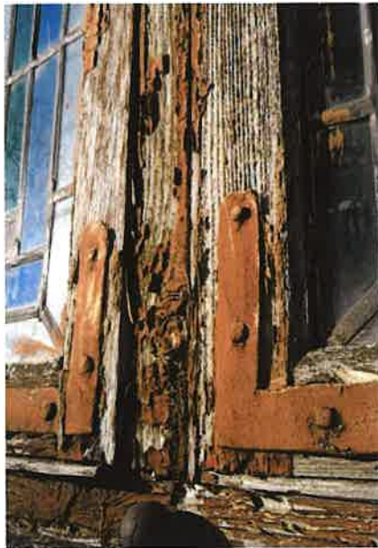
Fot. nr 135 Ściana południowa – katastrofalny stan stolarki okiennej zniszczonej przez korozją biologiczną
