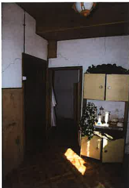
Fot. nr 151 Ściana wewnętrzna - widoczne liczne spękania ścian oraz ślady wilgoci
