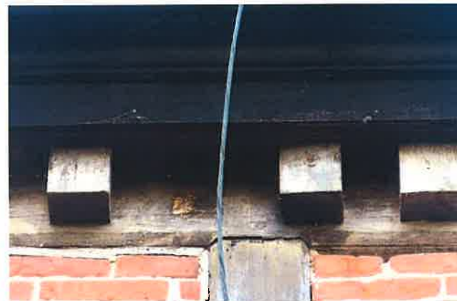
Fot. nr 56 Widoczne ubytki w elementach „ozdobnych” nabitych na rygle konstrukcji nośnej wokół gzymsu obwodowego
