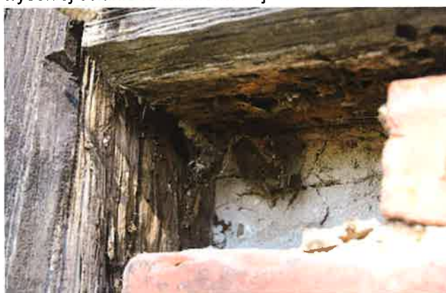
Fot. nr 31 Ściana południowa – ubytek w murze wypełniającym konstrukcję ryglową (otwór na wylot); w głębi widoczny tynk wewnętrzny
