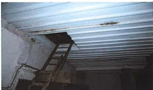
Fot. nr 115 Stan poszycie deskowego stropu-widoczne ślady zawilgocenia
