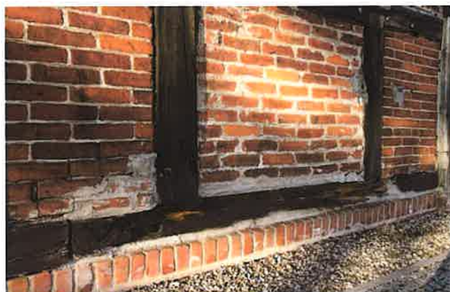
Fot. nr 73 Ściana południowa – nowe cegły poziomu cokołowego ułożone w 2009 roku; wypełnienie zaprawą cementową ubytków uszkodzonej ściany wypełniającej konstrukcję ryglową
