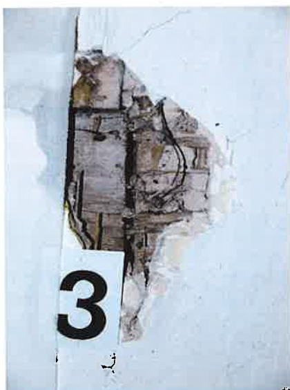
Fot. nr 87 Ściana południowa - stan tynków wewnętrznych; widoczne odpadające płyty tynku
