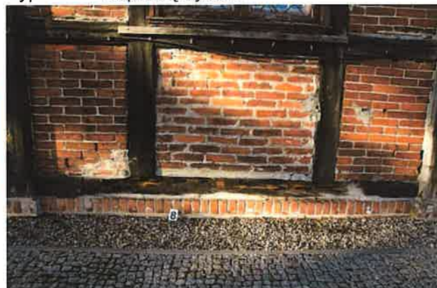
Fot. nr 22 Ściana południowa – uszkodzone i porażone elementy podwaliny; widoczne wypełnienie zaprawą wykonane podczas prac remontowych poziomu przyziemia w 2009 roku
