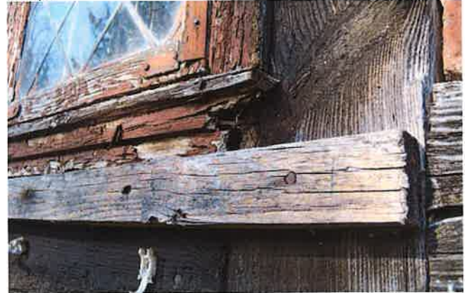
Fot. nr 136 Ściana południowa - katastrofalny stan stolarki okiennej zniszczonej przez korozją biologiczną
