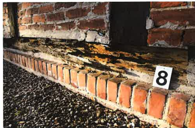
Fot. nr 26 Ściana południowa – uszkodzone i porażone przez korozję biologiczną (m.in. owady i grzyby) elementy podwaliny; widoczne duże ubytki w przekroju czynnym
