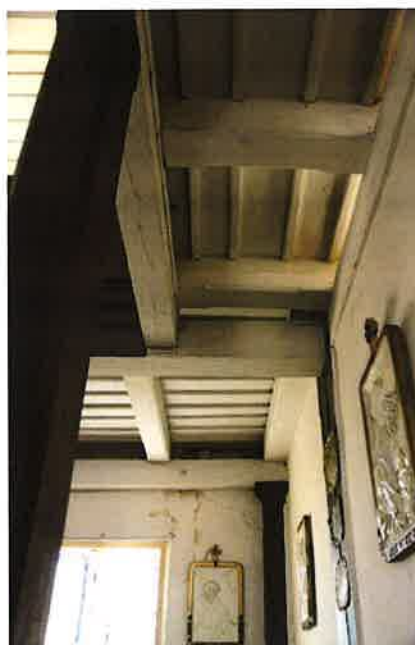
Fot. nr 100 Narożnik północno - zachodni - stan tynków wewnętrznych
