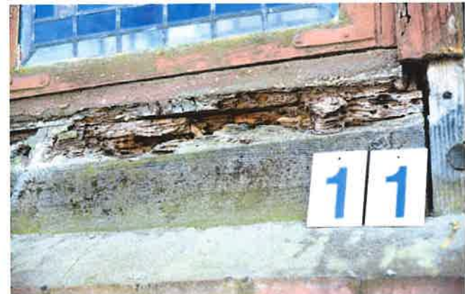
Fot. nr 138 Ściana północna – element podokienny oraz stan techniczny elementu ramy okiennej
