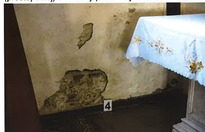
Fot. nr 98 Ściana północna - widoczne ślady zawilgocenia muru będące wynikiem podciągania kapilarnego wody (efekt braku izolacji poziomej)
