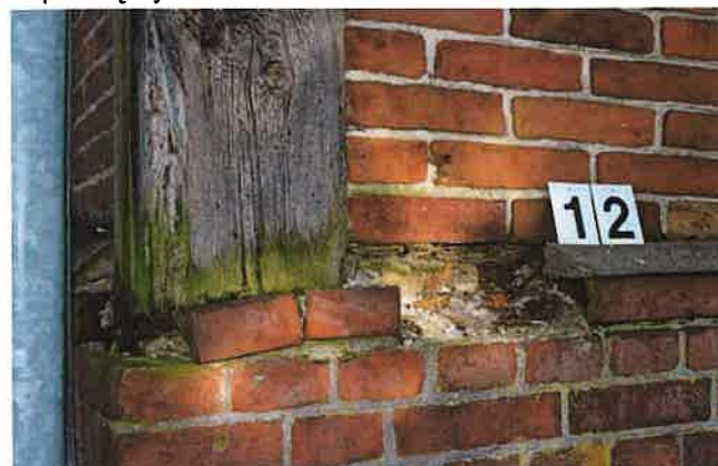
Fot. nr 27 Narożnik południowo – zachodni – widoczny ubytek muru cokołowego pod uszkodzonym okapnikiem cementowym zwieńczającym ścianę fundamentową; efekt przedostania się wód opadowych w głąb ściany ze względu na brak izolacji poziomej
