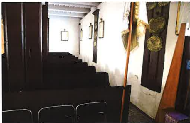
Fot. nr 99 Ściana północna – widoczne wzdłuż całej ściany ślady zawilgocenie ceglanego muru, będące wynikiem podciągania kapilarnego wody (efekt braku izolacji poziomej)
