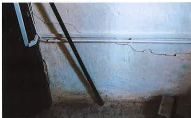
Fot. nr 153 Ściana zewnętrzna - widoczne liczne spękania ściany oraz ślady wilgoci (podciąganie kapilarne)
