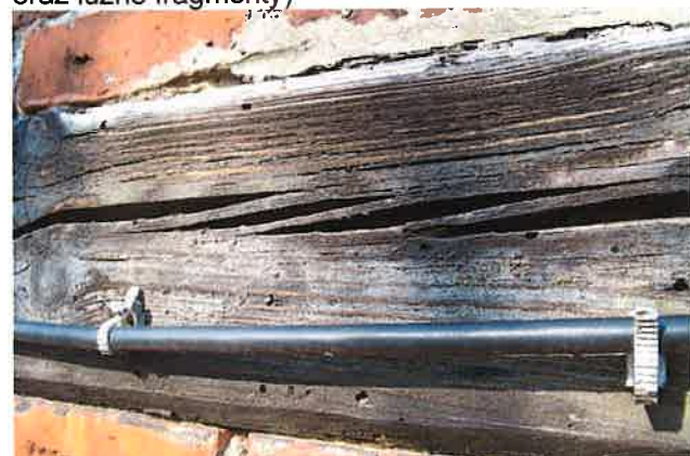
Fot. nr 34 Ściana południowa – stan techniczny elementów konstrukcji ryglowej; widoczna mocowana do elementu drewnianej konstrukcji instalacja elektryczna
