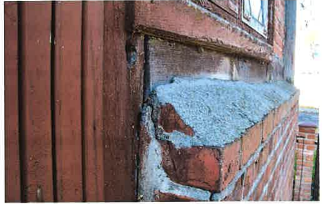
Fot. nr 134 Ściana wschodnia - zwieńczenie ściany fundamentowej wykonanym z zaprawy cementowej okapnikiem
