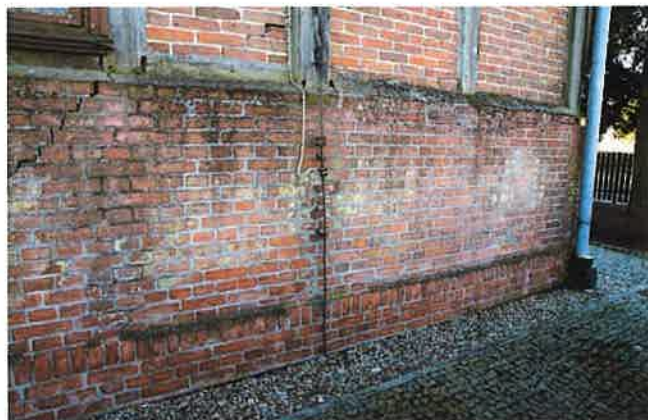
Fot. nr 43 Ściana północna – widoczna wysoka ściana fundamentowa zakończona odpadającym okapem
