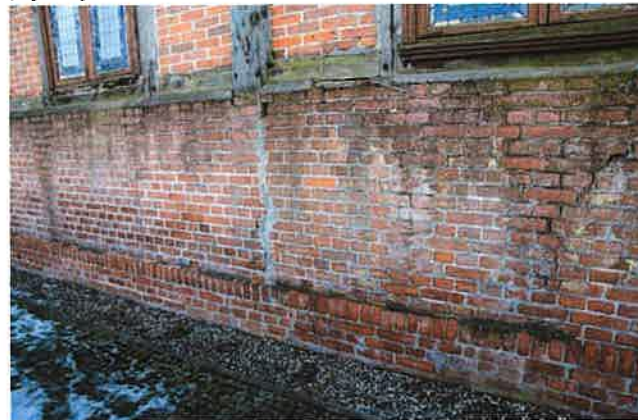
Fot. nr 44 Ściana północna – widoczna wysoka ściana fundamentowa, na której występują liczne pęknięcia muru oraz widoczne wielokrotne próby „zszycia” pęknięć
