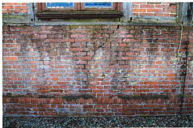
Fot. nr 42 Ściana północna – widoczna wysoka ściana fundamentowa, na której wzdłuż jej całej długości występują liczne pęknięcia i zarysowania muru oraz widoczne wielokrotne próby „zszycia” pęknięć muru
