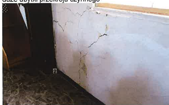
Fot. nr 85 Ściana południowa –spękane i odspajające się tynki wewnętrzne ścian wypełniających konstrukcję ryglową
