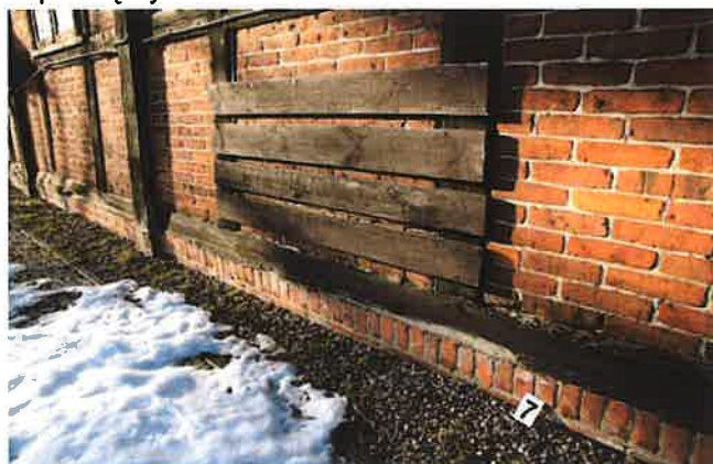
Fot. nr 21 Ściana południowa – uszkodzone i porażone elementy podwaliny; widoczne opaska żwirowa wykonana wraz z drenażem opaskowym w 2009 roku
