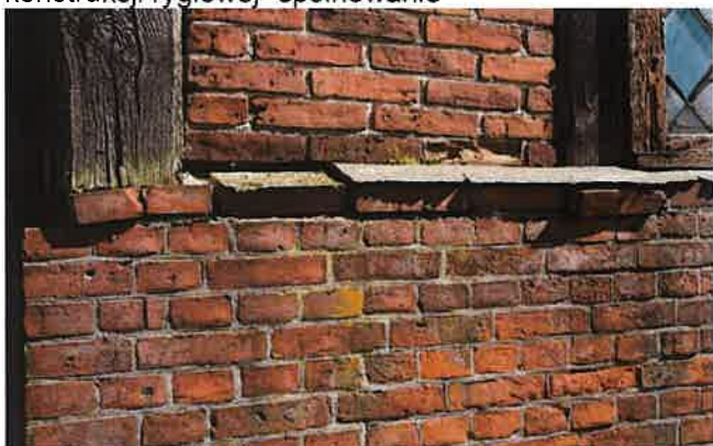
Fot. nr 65 Ściana południowa-ceglane wypełnienia konstrukcji ryglowej – widoczna cegła wysokiej ściany fundamentowej oraz oryginalnego wypełnienia
