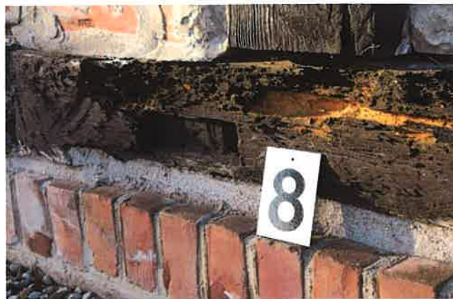
Fot. nr 24 Ściana południowa – uszkodzone i porażone przez korozję biologiczną (m.in. owady i grzyby) elementy podwaliny; widoczne wypełnienie zaprawą oraz wykonana podmurówka „na rolkę” w 2009 roku
