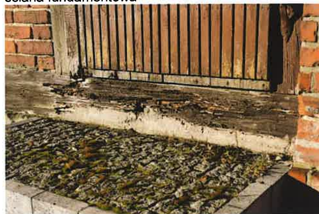
Fot. nr 40 Ściana wschodnia – stan belki podwalinowej w obrębie drzwi wejściowych
