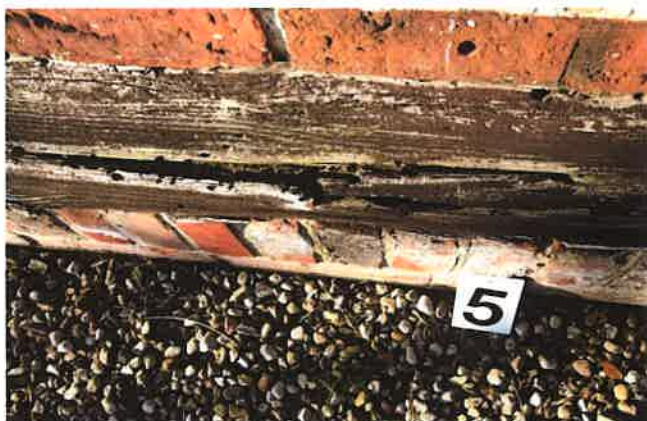
Fot. nr 17 Ściana południowa – uszkodzone i porażone przez korozję biologiczną (grzyby i owady) elementy podwaliny
