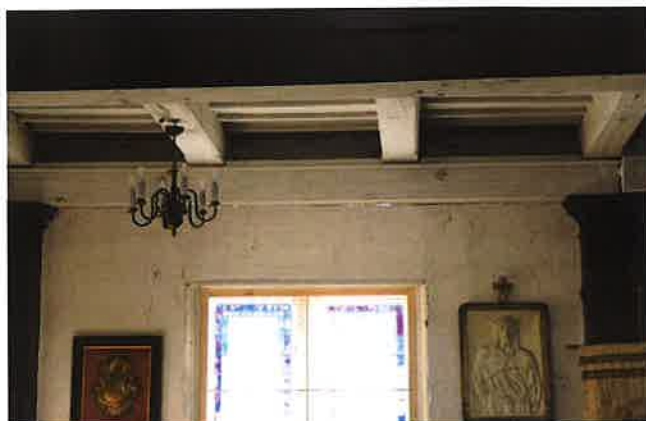
Fot. nr 94 Ściana południowa - stan tynków wewnętrznych; widoczny prześwit na „wylot” pod podciągami, na którym oparte są belki stropowe
