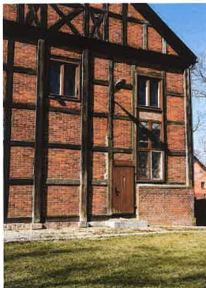
Fot. nr 36 Ściana wschodnia – wysoka ściana fundamentowa narożnika północno – wschodniego; widoczny wprowadzony nowy otwór okienny zaburzający pierwotną formę stolarki okiennej
