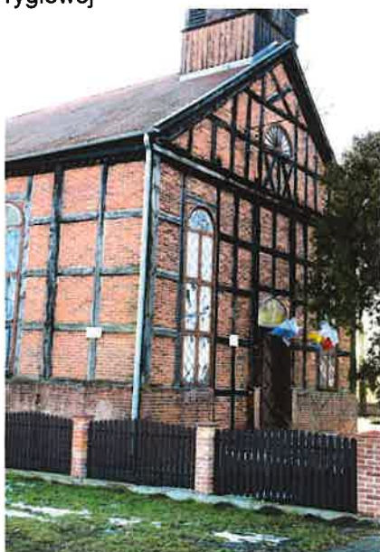
Fot. nr 49 Północno -zachodni narożnik – widoczne osiadanie tej części kościoła
