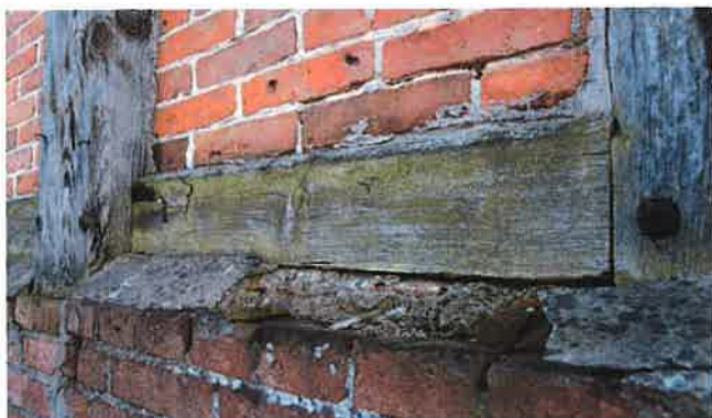
Fot. nr 145 Ściana północna - stan cementowego okapnika ochronnego zwieńczającego ścianę fundamentową
