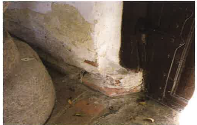
Fot. nr 160 Ściana zachodnia - strefa przyziemia w obrębie wejścia-widoczne ślady wilgoci będące efektem podciąganie kapilarnego wody
