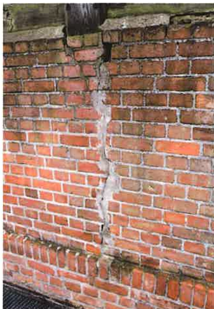
Fot. nr 47 Ściana północna – widoczna wysoka ściana fundamentowa; próby „zszycia” pęknięcia; stan cementowego okapu zwieńczającego oraz widoczny sposób oparcia drewnianego słupa konstrukcji ryglowej
