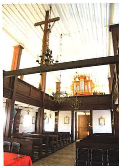
Fot. nr 92 Wnętrze kościoła - widok na empore - widoczna szczelina w poziomie balustrady narożnika północno- zachodniego
