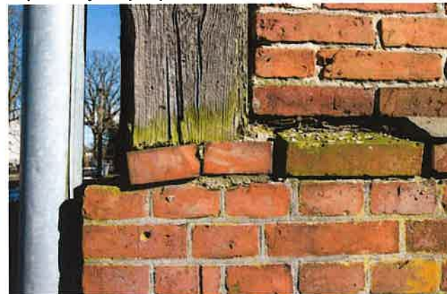
Fot. nr 28 Narożnik południowo – zachodni – widoczne „luźne” cegły muru oraz „sposób” oparcia drewnianego słupa narożnego na wykonanej ścianie fundamentowej
