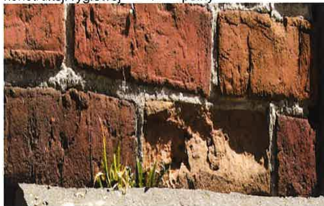
Fot. nr 66 Ściana południowa - widoczne ubytki w powierzchni cegły wypełniającej - mur oryginalny
