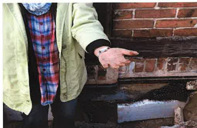
Fot. nr 131 Ściana południowa - wykop badawczy zewnętrzny - stwierdzenie dużej wilgotności muru fundamentowego, który był osłonięty folią kubelkową
