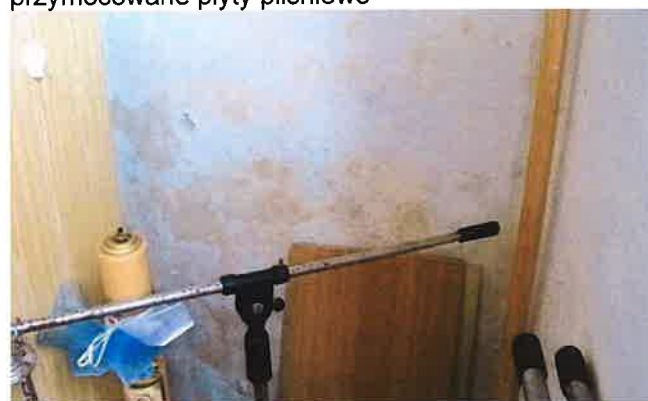
Fot. nr 154 Ściana zewnętrzna - widoczne ślady wilgoci (podciąganie kapilarne)
