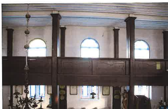
Fot. nr 89 Widok na empore - ściana północna; widoczna szczelina w linii balustrady oraz deformacja narożnika północno -zachodniego
