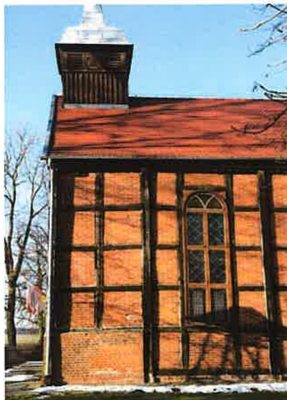
Fot. nr 12 Narożnik południowo-zachodni - wysoka ściana fundamentowa będąca efektem usunięcia dolnych podwalin i słupów (prawdopodobnie porażonych i uszkodzonych przez korozję biologiczną)
