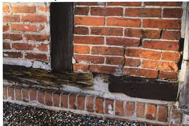
Fot. nr 72 Ściana południowa – nowe cegły poziomu cokołowego ułożone w 2009 roku; wypełnienie zaprawą cementową ubytków uszkodzonej ściany wypełniającej drewniany szkielet; głębokie pęknięcie muru
