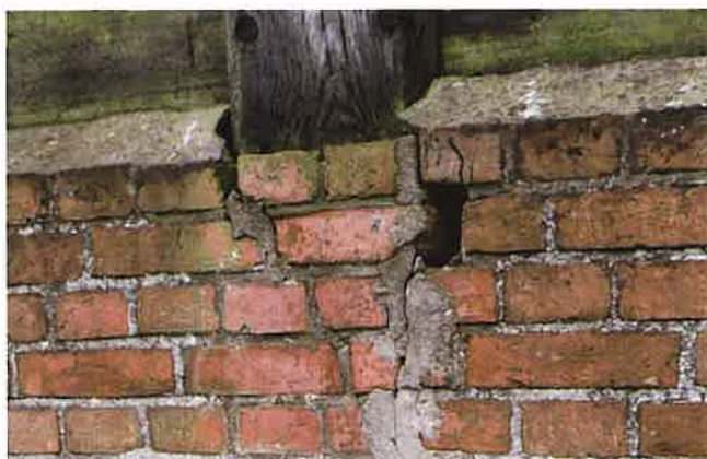
Fot. nr 71 Ściana północna – oparcie słupa konstrukcji ryglowej na wysokiej fundamentowej; widoczne głębokie pęknięcie ściany w strefie przypodporowej
