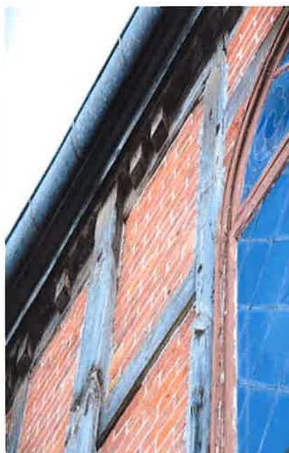
Fot. nr 60 Ściana północna – widoczne ubytki w nabitych na ryglach elementach „ozdobnych” wokół gzymsu okalającego
