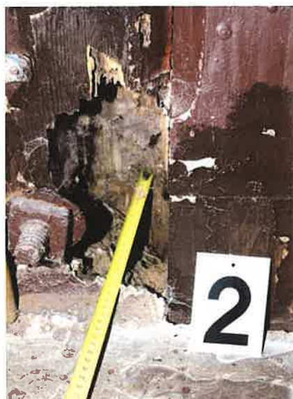
Fot. nr 83 Uszkodzone przez korozję biologiczną (m.in. grzyby) słupy drewniane (konstrukcji ryglowej) w kształcie litery T – ściana południowa; widoczne duże ubytki przekroju czynnego
