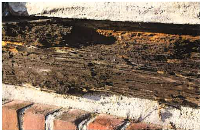
Fot. nr 23 Ściana południowa – uszkodzone i porażone przez i korozję biologiczną (m.in. owady i grzyby) elementy podwaliny; widoczne wypełnienie zaprawą wykonane w 2009 roku
