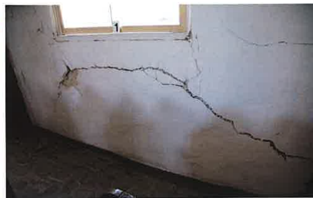
Fot. nr 86 Ściana południowa – liczne głębokie spękania tynków wewnętrznych
