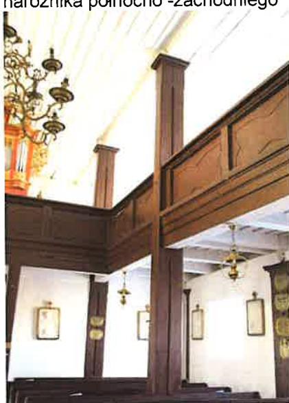
Fot. nr 91 Widok na empore - widoczna szczelina w poziomie balustrady będąca efektem osiadania narożnika północno-zachodniego
