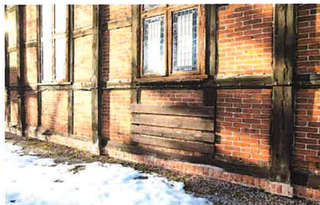
Fot. nr 16 Ściana południowa – pierwotna forma konstrukcji ryglowej – stan techniczny elementów drewnianych
