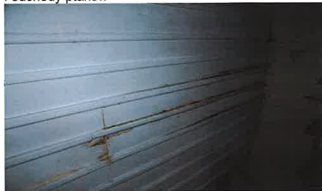
Fot. nr 116 Stan poszycie deskowego stropu - widoczne ślady zawilgocenia
