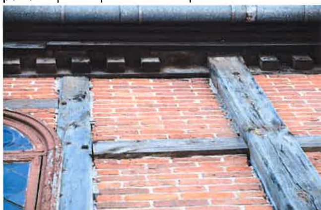
Fot. nr 59 Ściana północna – widoczne ubytki w nabitych na ryglach elementach „ozdobnych” wokół gzymsu okalającego
