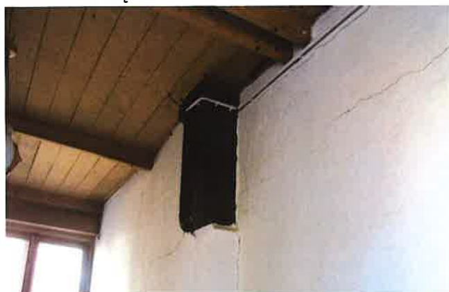
Fot. nr 147 Wnętrze zakrystii – forma słupa wewnętrznego - widoczne poziome pęknięcia i zarysowania ściany wewnętrznej
