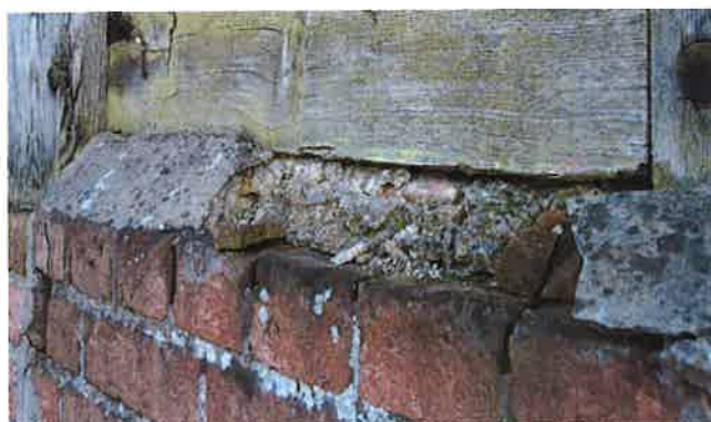
Fot. nr 146 Ściana północna – popękany i odpadający cementowy okapnik
