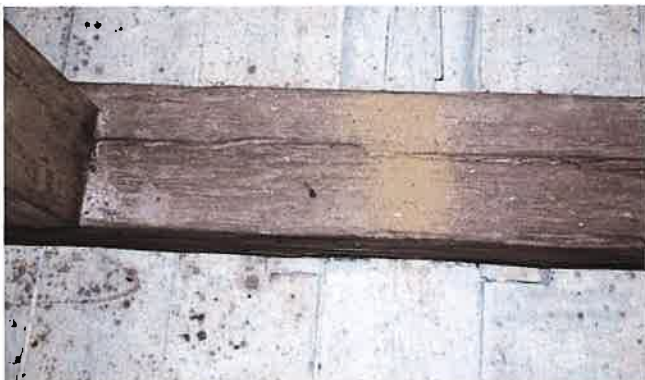
Fot. nr 113 Konstrukcja więźby dachowej-belka stropowa-widoczne ślady żerowania owadów
