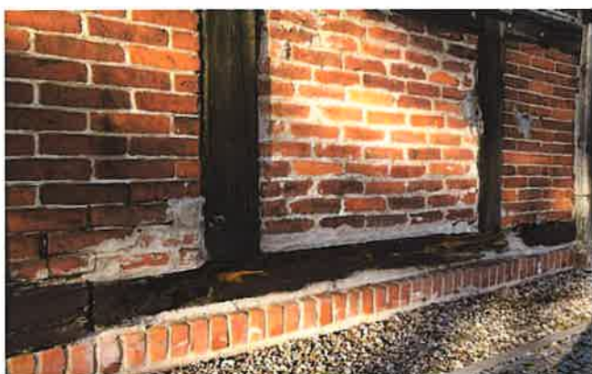
Fot. nr 15 Ściana południowa – uszkodzone podwaliny oraz widoczne przemurowanie (na rolkę) ściany fundamentowej wykonane w 2009 roku
