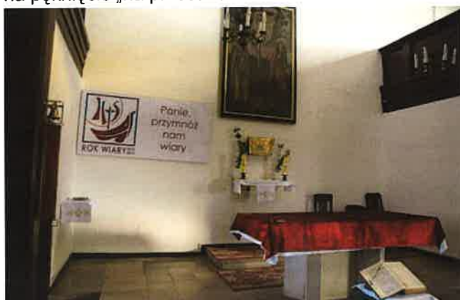
Fot. nr 95 Wewnętrzna ściana poprzeczna - widoczne pęknięcia i zarysowanie wokół konstrukcji ryglowej
