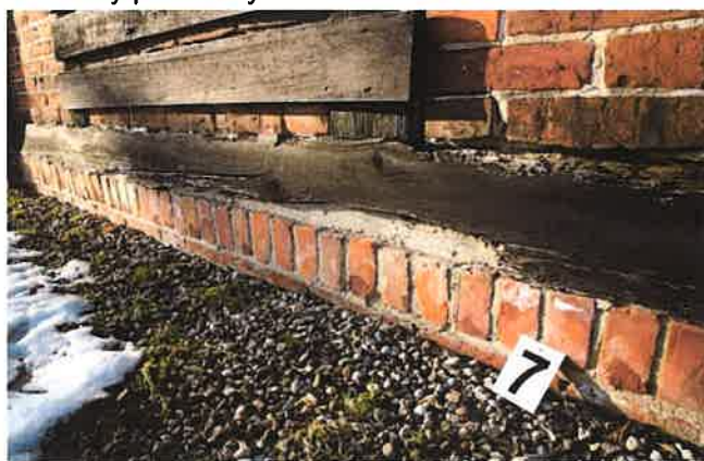
Fot. nr 19 Ściana południowa – uszkodzone i porażone elementy podwaliny; widoczne wypełnienie zaprawą wykonane w 2009 roku
