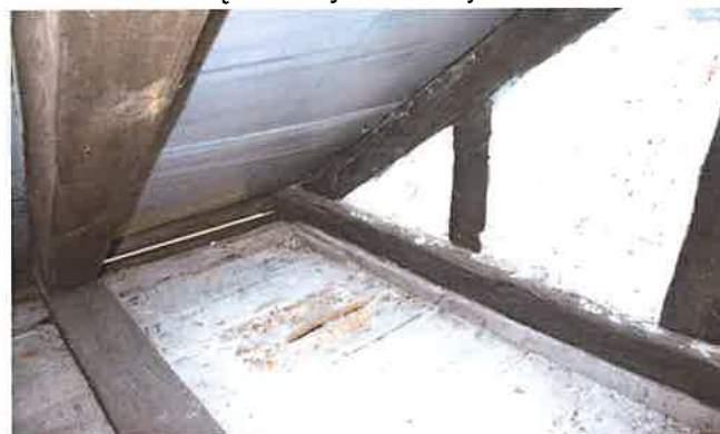
Fot. nr 111 Konstrukcja więźby dachowej-widoczny prześwit części przyokapowej
