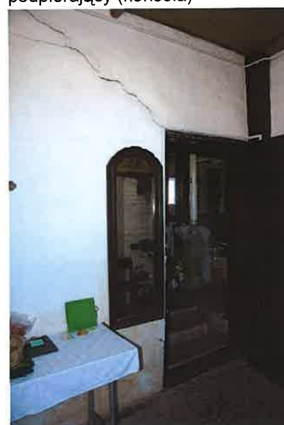
Fot. nr 150 Ściana wewnętrzna (zakrystia) ukośne pęknięcie ściany o dużym rozwarciu
